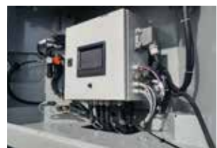
IMPIANTI ELETTRICI A CONNESSIONE Consentono una facile manutenzione.
